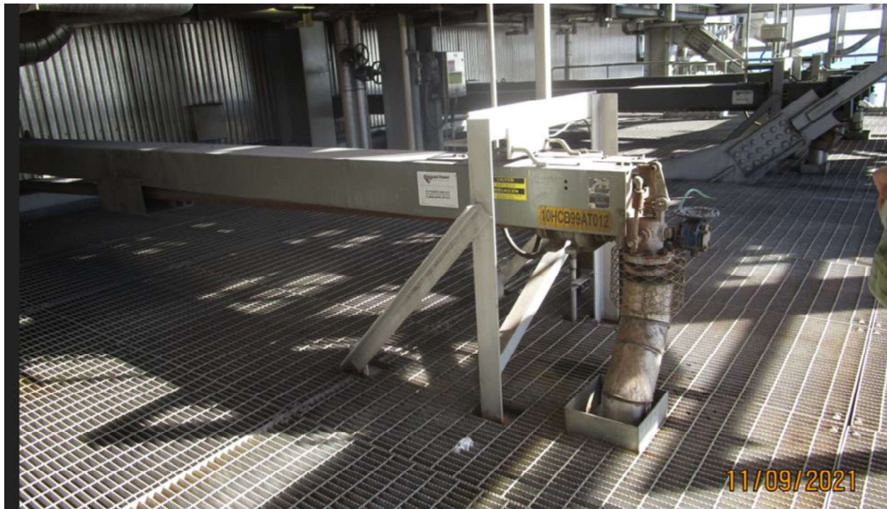
Figura 3-25 — Soplador de Hollín de la Caldera
