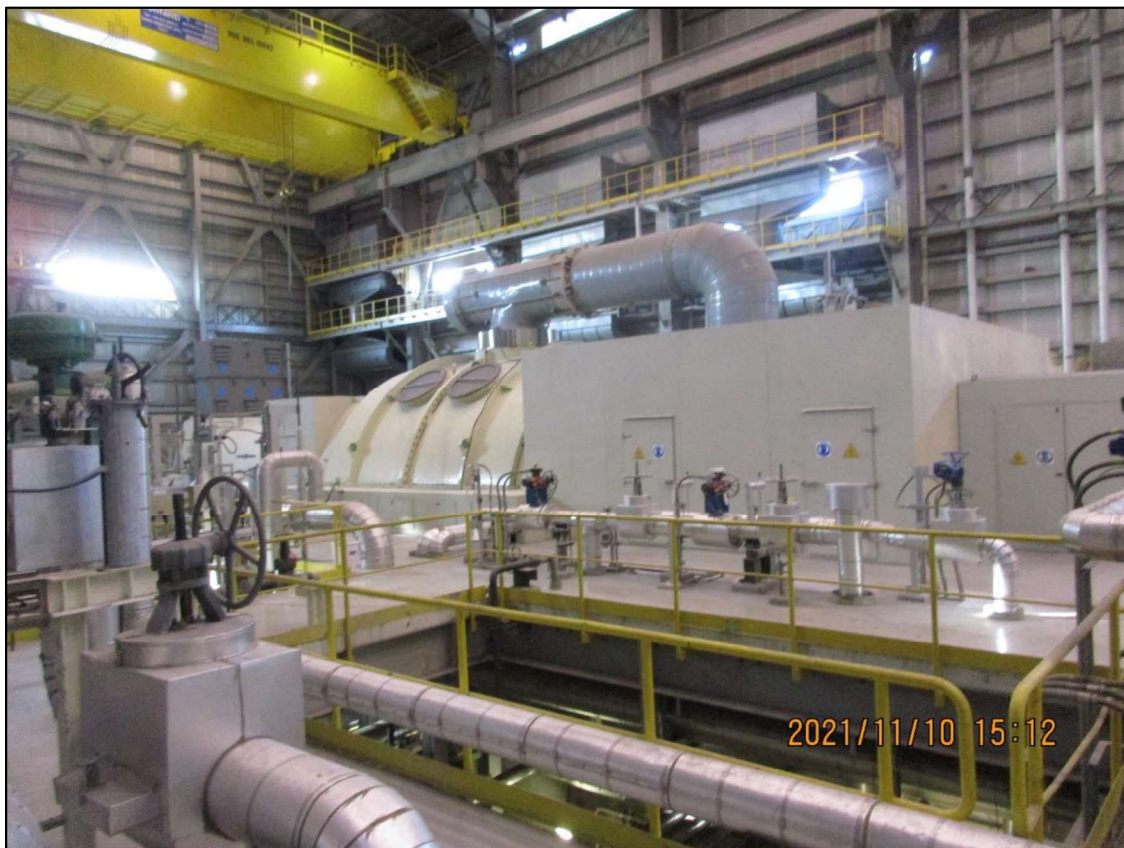
Figura 3-27 — Generador de Turbina de Vapor de Punta Catalina
