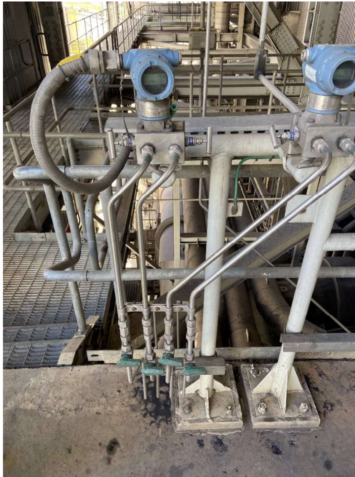
Figura 3-43 — Transmisor de Presión Diferencial del Molino con Drenado en el Suelo
