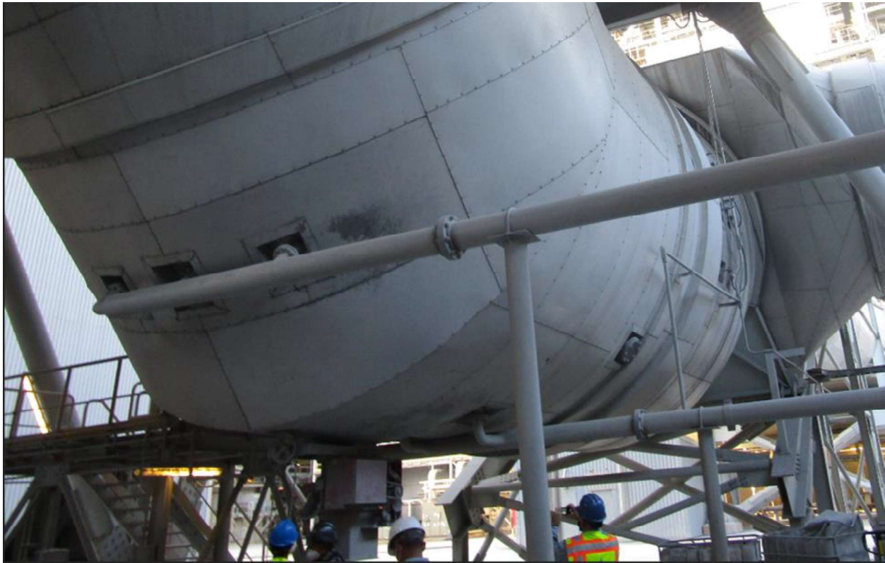
Figura 3-35 — Codo de Entrada de CFB
