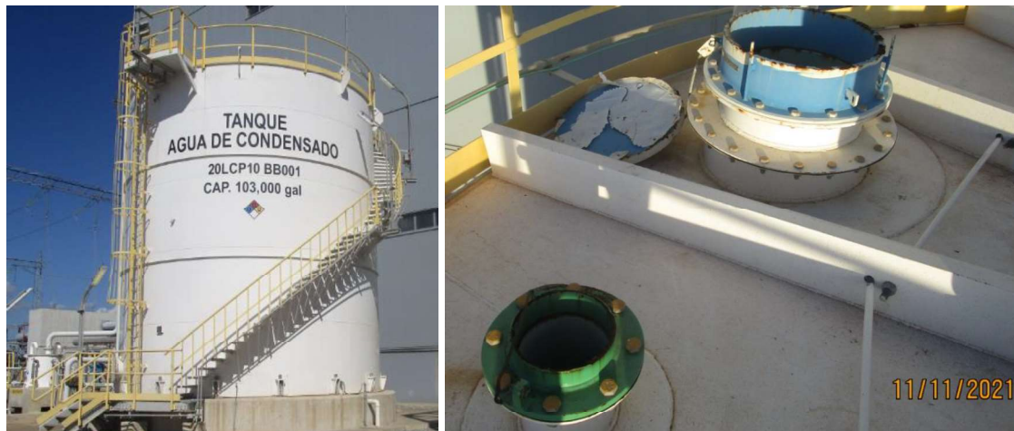
Figura 3-28 — Tanque de Almacenamiento de Condensado
